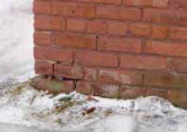
Mur de briques dont les rangées inférieures ont besoin d'un rejointoiement
