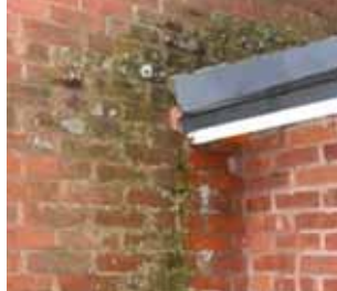
Mur de briques altéré par l'humidité en raison de l'absence de gouttières
