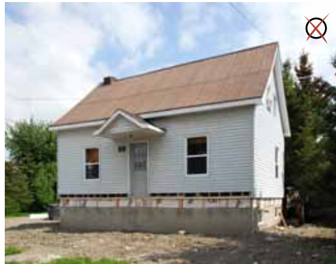
Nouvelle fondation en béton trop haute qui aurait avantage à être remblayée.
