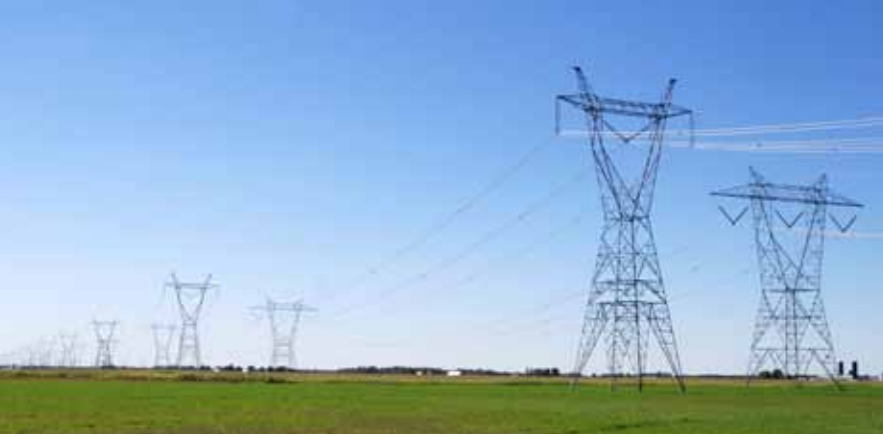
Lignes de transmission hydroélectrique
